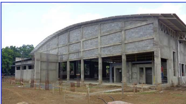
Vista panorámica del Gimnasio de Gimnasia, donde se aprecia a la izquierda fachada Norte sin proyecto y a la derecha fachada Norte con el proyecto ya finalizado.
